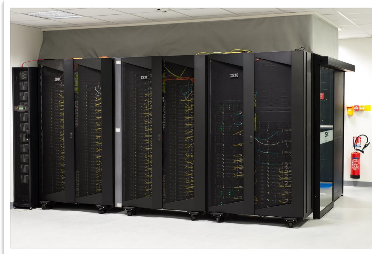
Calculateur ANTARÈS installé dans le Centre de Données Régional
